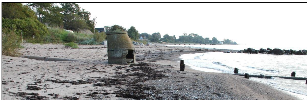
Figur 7-5 Blottad dagvattenledning och brunn som får förmodas ha haft sand kring sig betydligt högre upp.
