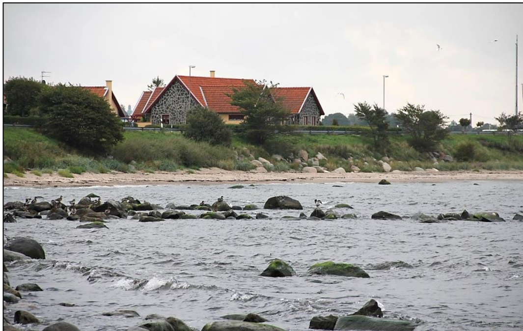
Figur 7-11 Gammalt erosionsskydd i slänten nedanför riksväg 9 vid Klintholmen.
